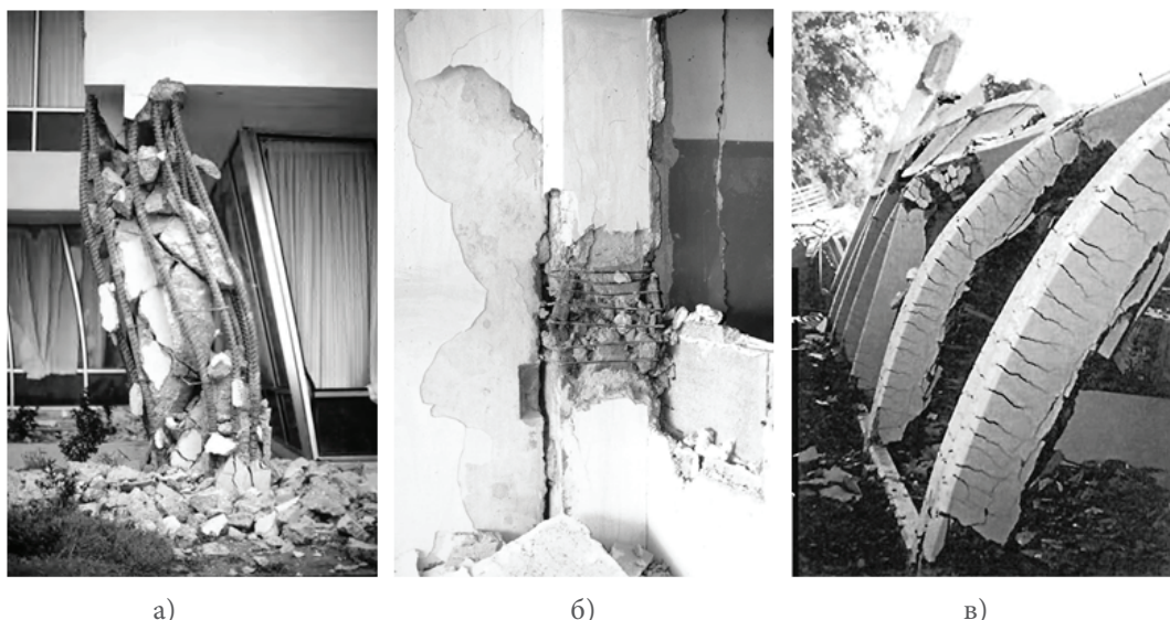
Рис. 1. Повреждения колонн каркасных зданий во время землетрясений:
